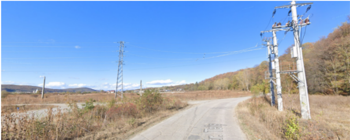
Linii electrice aeriene, linii de telecomunicații.
