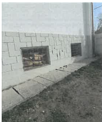
Foto 03 – Vedere degradari trotuar perimetral.
