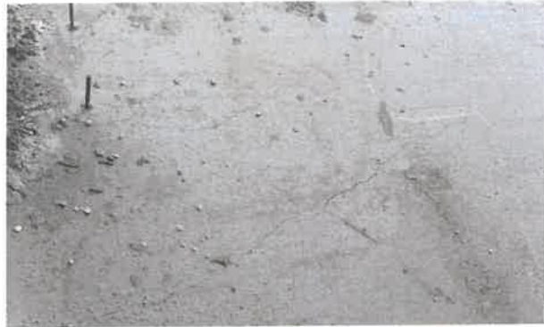
Img. 1 - fisuri în placa de pardoseală
