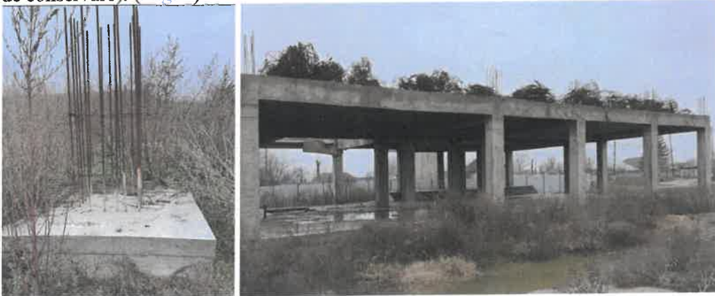
Img.6 – armături neprotejate
