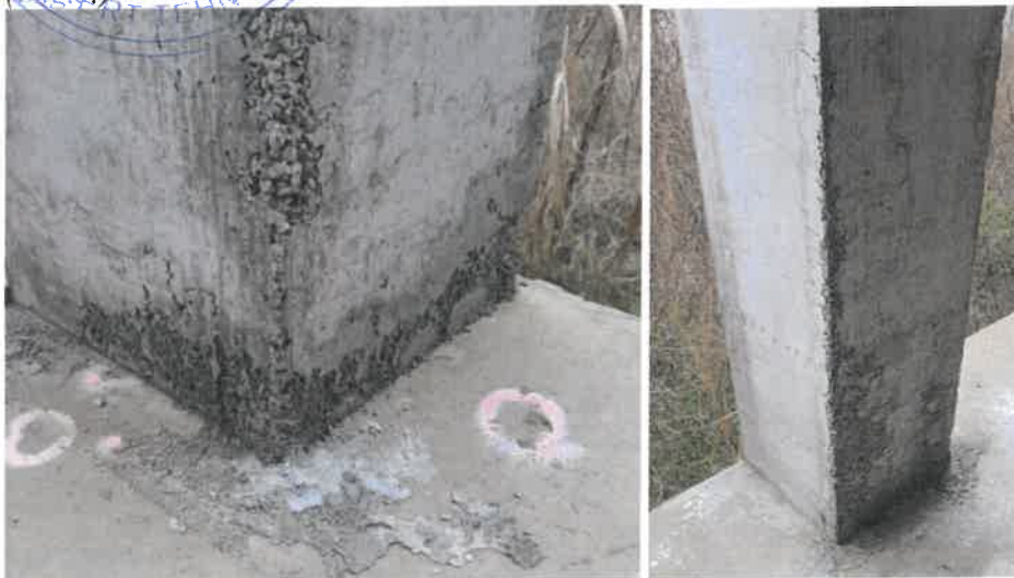
Img.3. - beton segregat la nivelul stâlpilor
