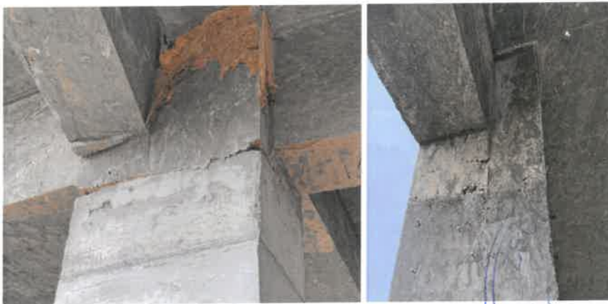
Img.5. – turnare,cofrare,decofrare încorect executate
