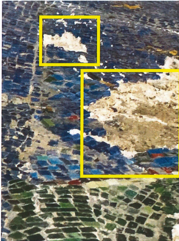
Pierderea de material și formarea lacunei rezultată în urma apariției eflorescențelor saline.
