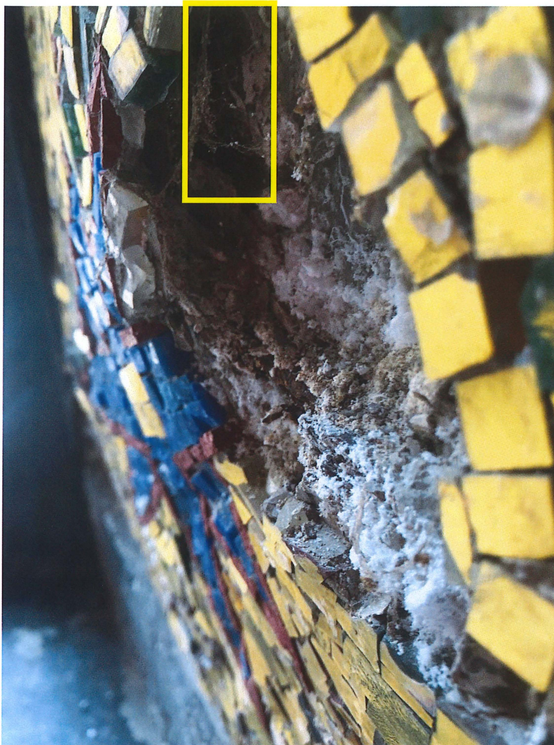
Fotografie de detaliu ce evidențiază stadiul avansat de macerare a stratului de suport atacat de umiditate prin crearea de eflorescențe saline. Se notează elementul metalic existent care a provocat dislocarea (explodarea stratului suport) prin crearea unei lacune profunde.
