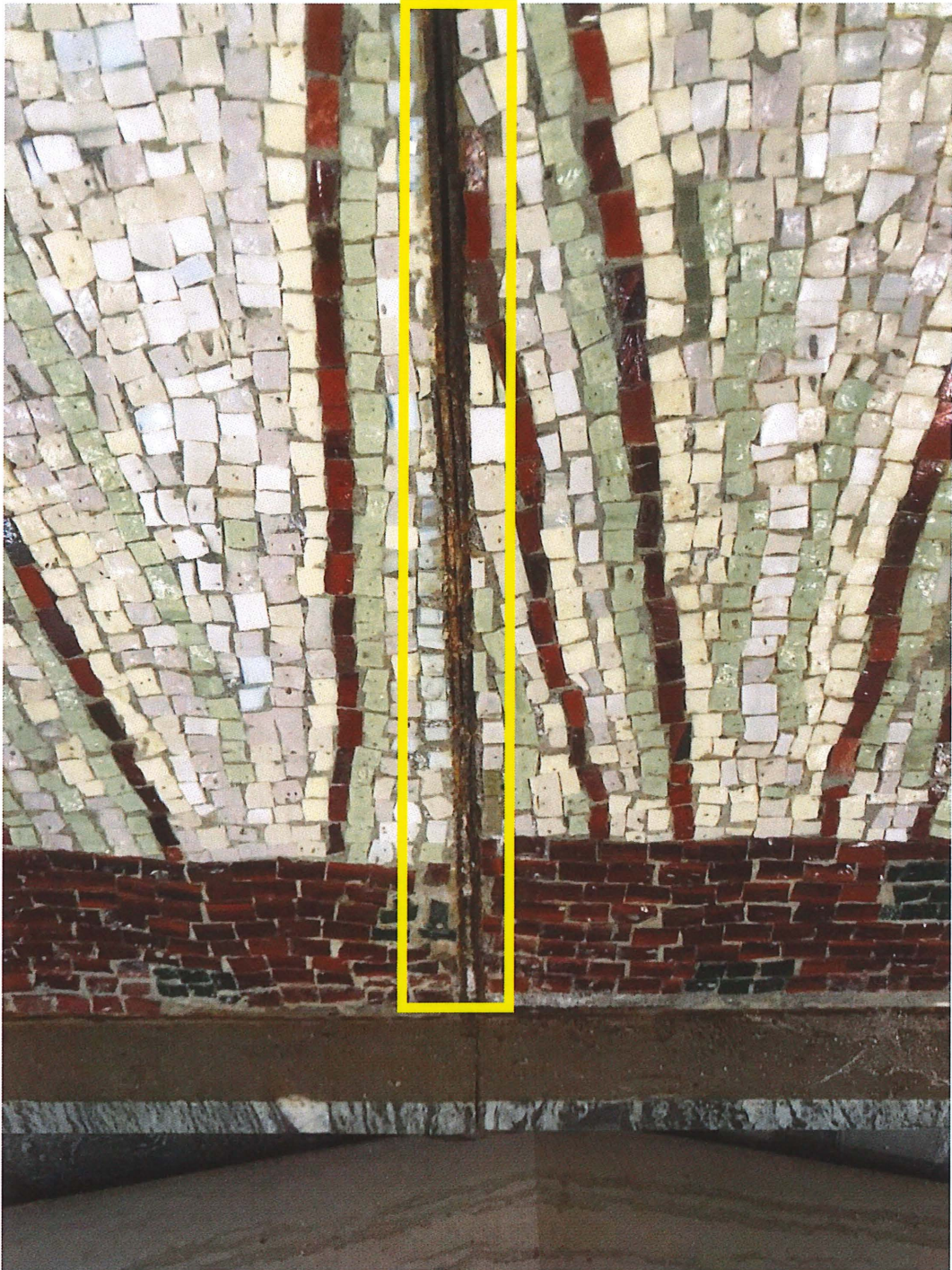
Desprindere pe toată lungimea barei metalice, care a suferit un atac de coroziune.
