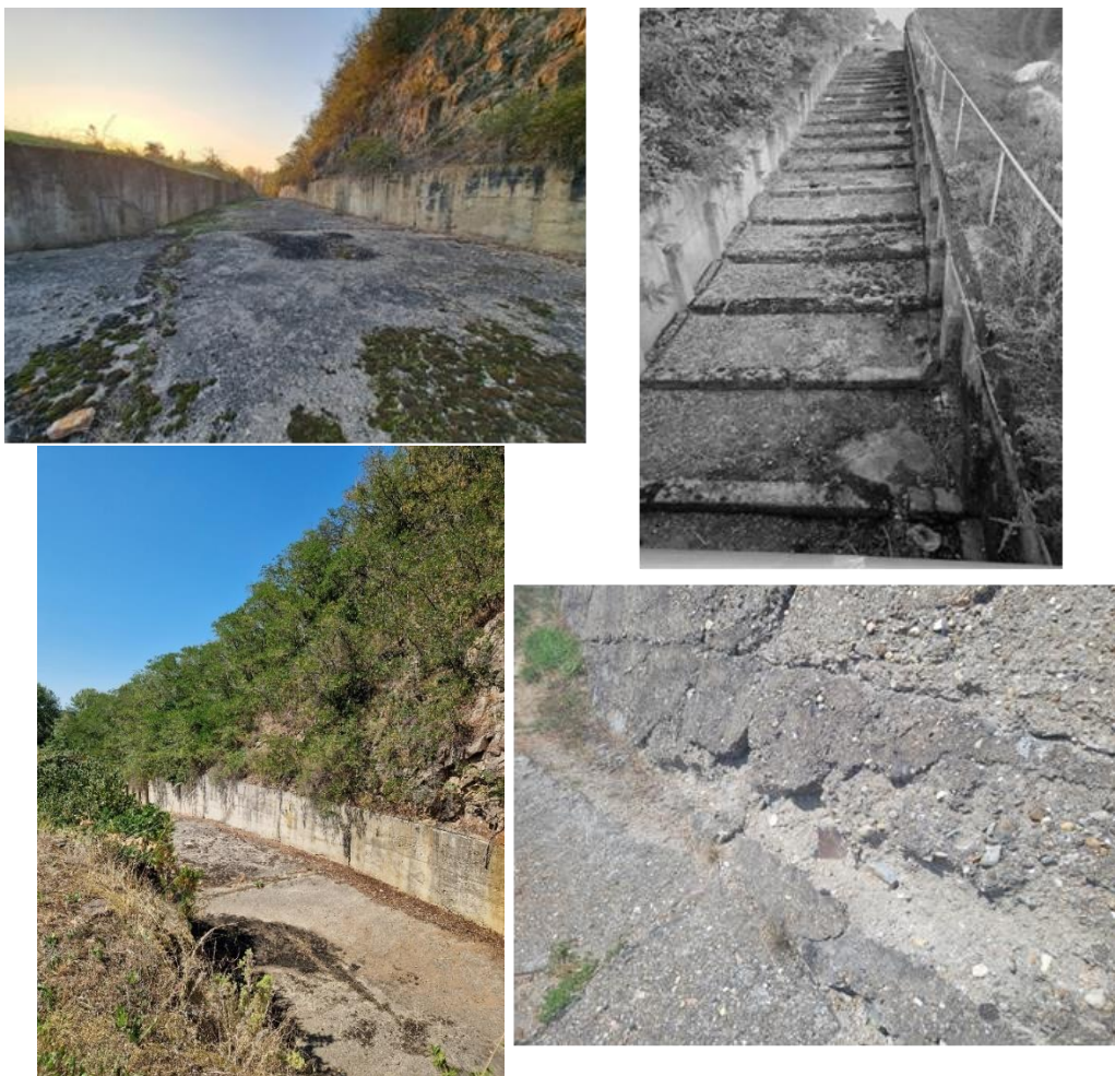
Foto 1. Aspecte privind starea structurala a descărcătorului de ape mari
