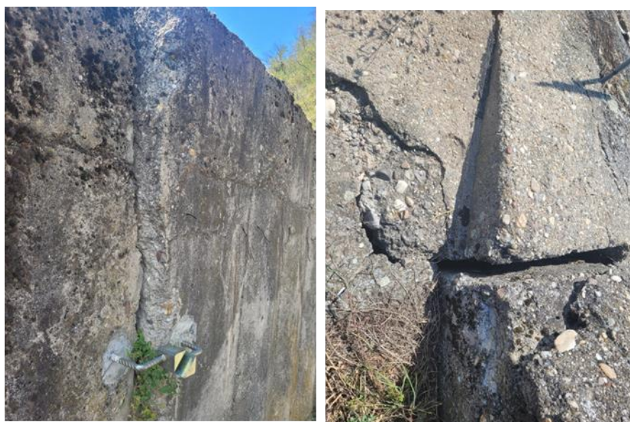
Foto 2. Crăpătura in zidul de garda cu tendințe de deplasare
