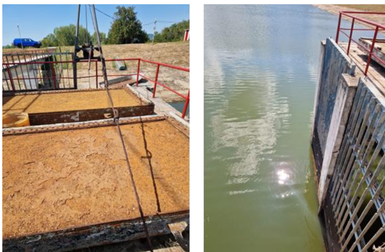
Foto 4. Elemente de batardou nefuncționale si grătare deteriorate
