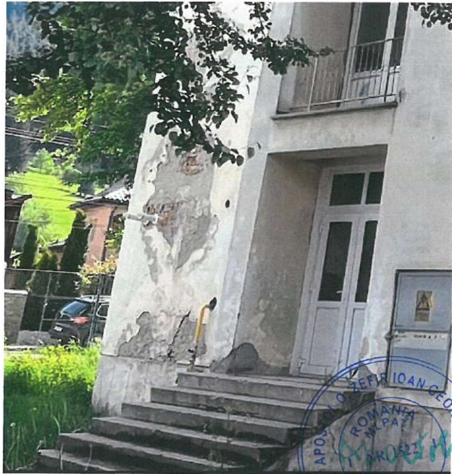
Foto 7 - Tenuieli locale degradate
