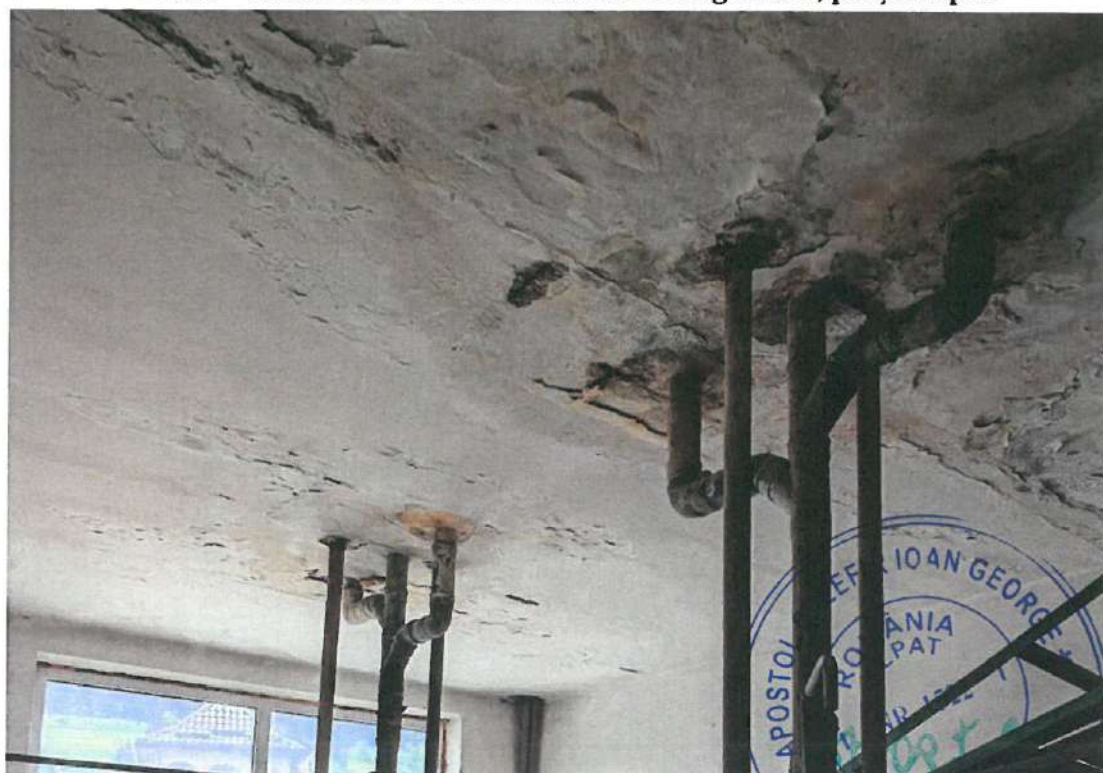
Foto 6 - Planșeu parțial degradat
