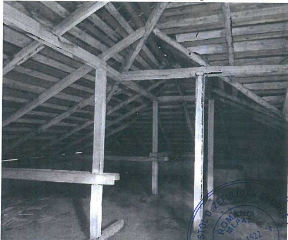
Foto 4 - Șarpantă într-o stare avansată de degradare
