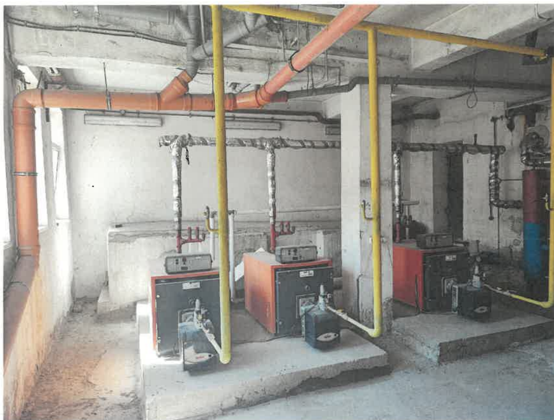
Fig. 11: Centrala termică, demisol
