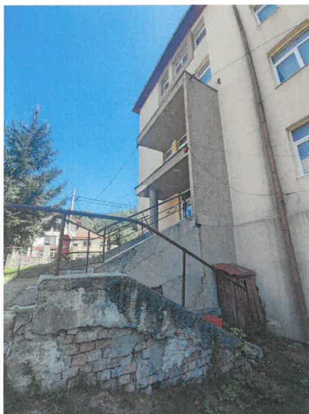
Fig. 12: Scări de acces la intrarea principală, degradate
