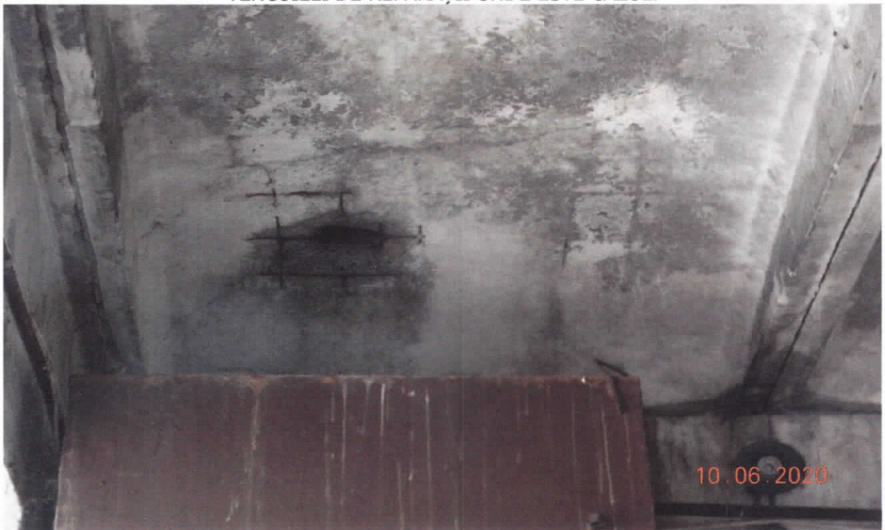
FOTO 4. SE VERIFICĂ STAREA ARMĂTURILOR PLĂCII ȘI SE FAC REPARAȚII CU TENCUIELI DE REPARAȚII .DACĂ ARMĂTURA ESTE DEGRADATĂ DE CONSOLIDEAZĂ CU PLASĂ DE SÂRMĂ ȘI SE TORCRETEAZĂ SPRITZBETON HASIT 470 PENTRU REPARAȚII ,SE FINISEAZĂ APOI SUPRAFATA CHESONULUI.
