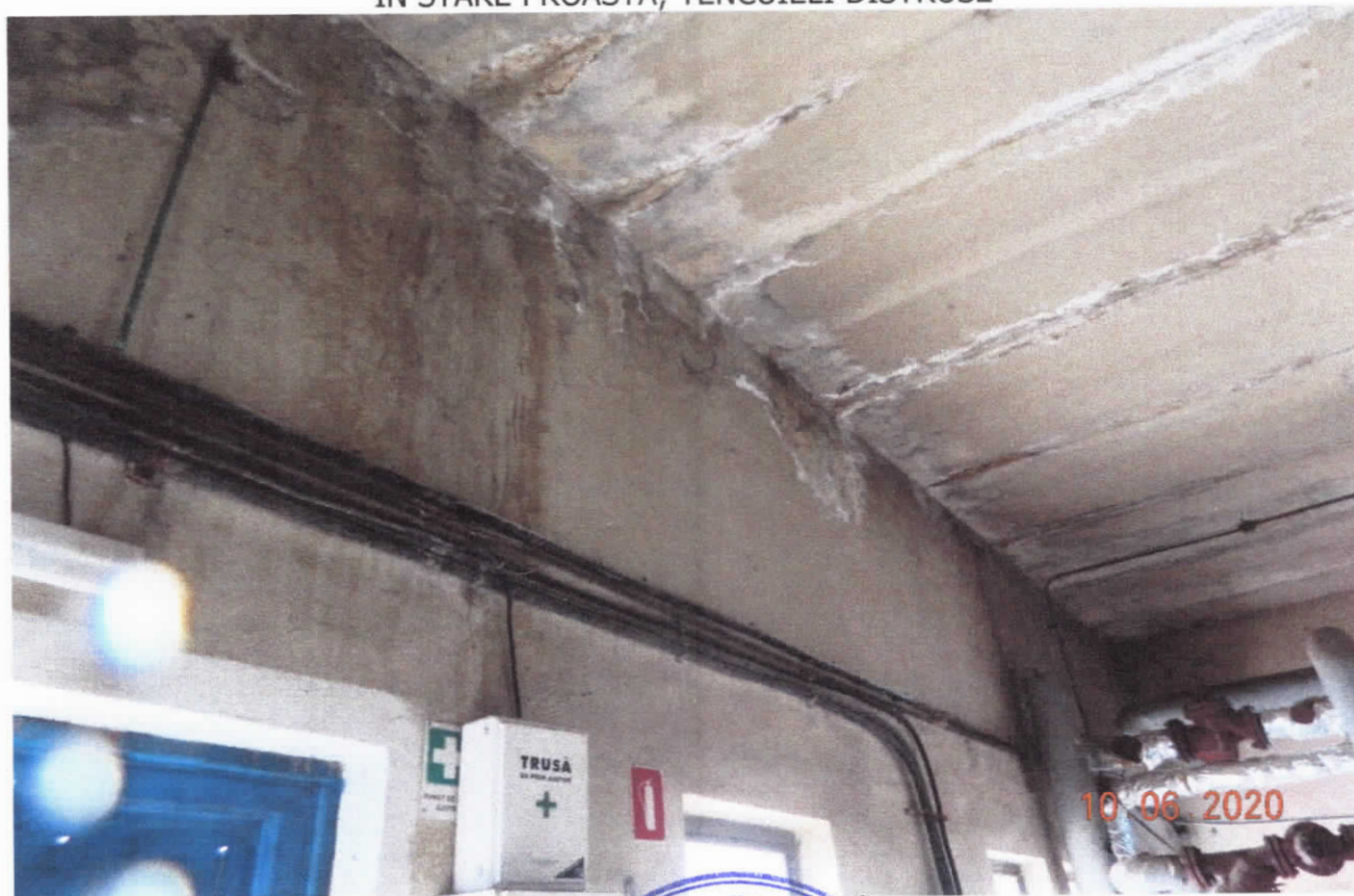
FOTO 2. ALCĂTUIREA PLANȘEI ACOPERISULUI DIN FĂȘII CU GOLURI, INFILTRAȚII DIN APA PLUVIALĂ
