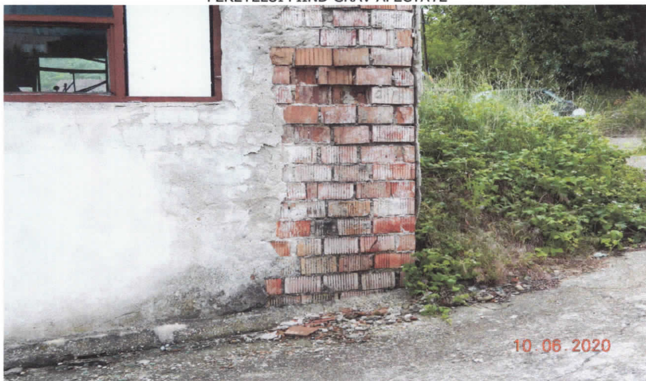
FOTO 2 . SE VA INTRODUCE STĂLPIȘORI DIN BETON ARMAT LA COLȚURI CARE SE VOR ANCORA ÎN CENTURA PERIMETRALĂ LA NIVELUL PLĂCII DE ACOPERIȘ ȘI ÎNTR-UN BULB ARMAT CARE SE VA FORMA LA FUNDAȚIE
