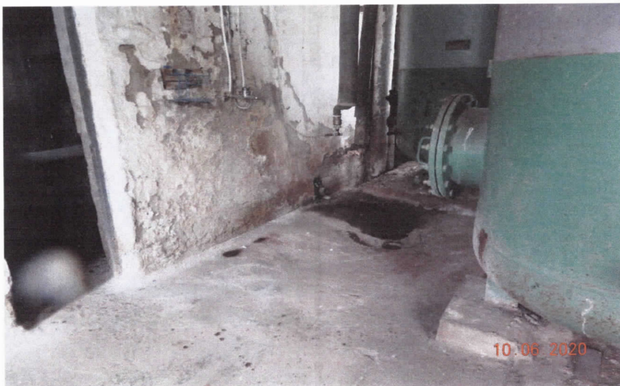
FOTO 3. TENCUIELI INTERIOARE ÎNTR-UN STADIU AVANSAT DE DEGRADARE – EFLORESCENȚA LA PERETELE SATURAT DE APĂ DIN CONDENS ȘI INSTALAȚII DEFECTE
