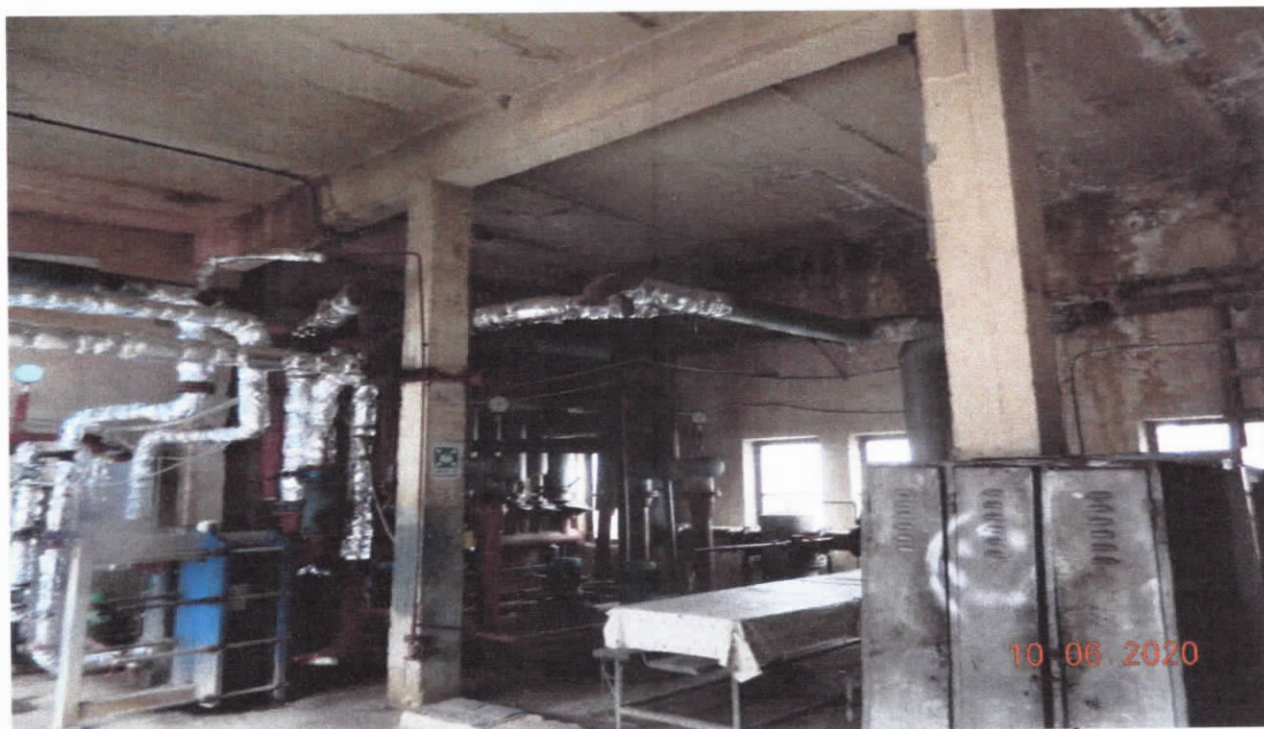
FOTO 1. – STRUCTURA PUNCTULUI TERMIC – PT1 – INFILTRAȚII LA TAVANE ÎNVELITOAREA ÎN STARE PROASTĂ, TENCUIELI DISTRUSE
