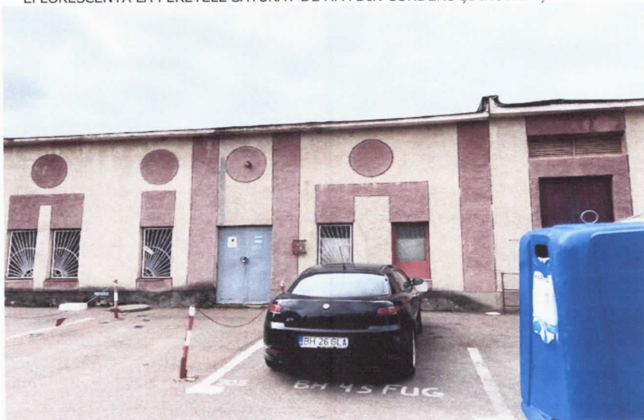
FOTO 4. DISTRUGEREA SOCLULUI DE LA STROPUL DE APA PLUVIALĂ DIN SCURGAREA ACOPERIȘULUI FĂRĂ PRELUAREA APELOR PLUVIALE ÎN JGHEABURI ȘI BURLANE
