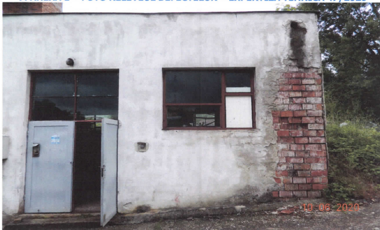
FOTO 1. SCURGEREA APELOR PLUVIALE SE FĂCEA PRINTR-UN GARGUI CARE ESTE DISTRUS ,NICI BURLANUL NU MAI EXISTĂ APA SCUGÂNDU-SE PE PERETE ,ZIDĂRIA ȘI TENCUIALA PERETELUI FIIND GRAV AFECTATE
