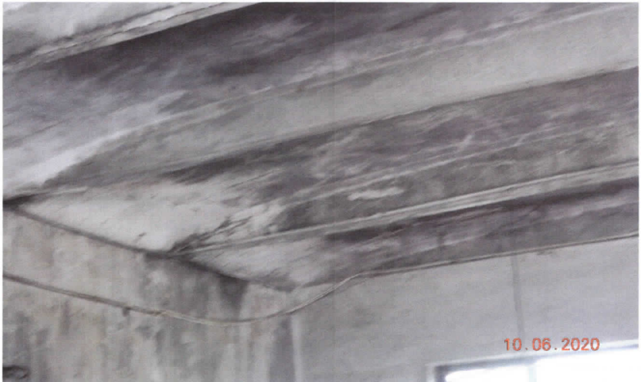
FOTO 3. CHESOANE ÎN STARE PROASTĂ , CARE SE VOR CURĂȚA ȘI CONSOLIDA CU TENCUIELI DE REPARAȚII UNDE ESTE CAZUL.
