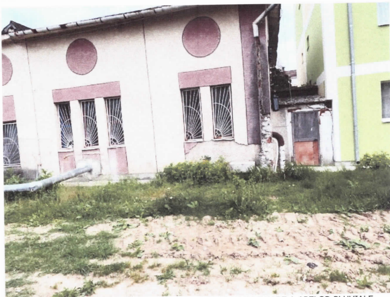
FOTO 5. PERETE DISTRUS DE LIPSA BURLANULUI DE PRELUARE A APELOR PLUVIALE , SISTEMUL DE PRELUARE ȘI EVACUARE AL APELOR PLUVIALE ÎN STARE PROASTĂ ȘI DISTRUS PE MULTE PORȚIUNI.
