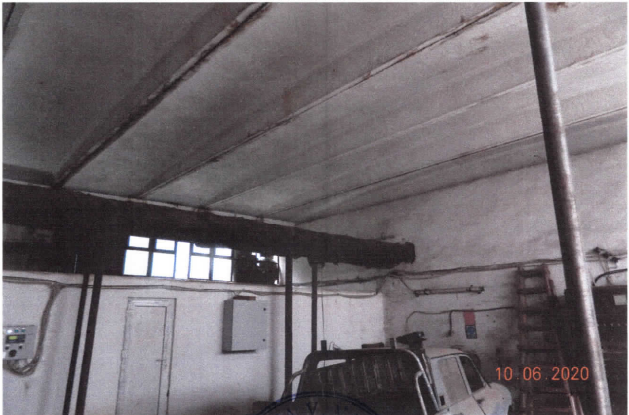
FOTO 2. ACOPERIȘUL DIN CHEȘOANE PREFABRICATE, INFILTRAȚII DIN ACOPERIȘ
