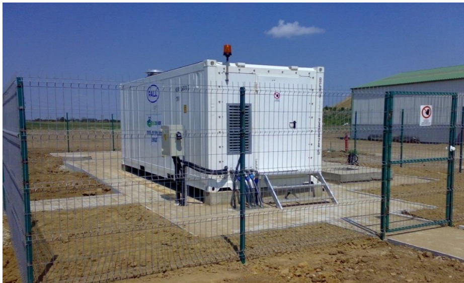
Figura nr.8 Statia de tratare a levigatului Ciocanesti, cu osmoza inversa
