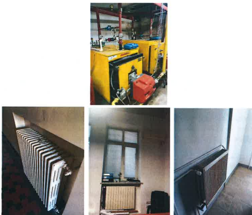
Figura 6– Centrala termica si corpuri de incalzire
