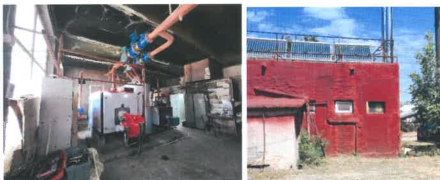
Figura 7 – imagini din clădirea C4 – centrala termică
