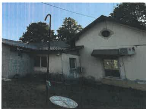
Foto 06 – Degradari locale ale tencuielii la exterior
