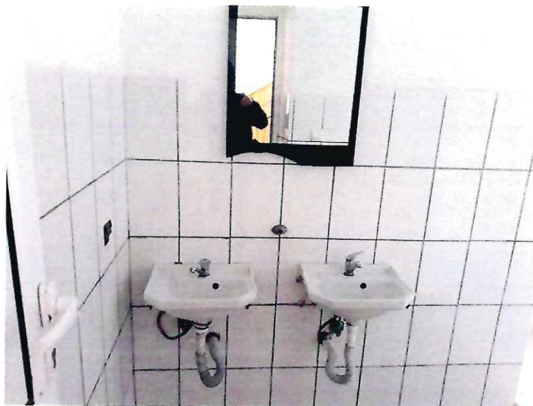
Figura 9 – Lavoare grup sanitar
