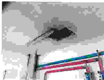
Figura 5.- Corp de iluminat
