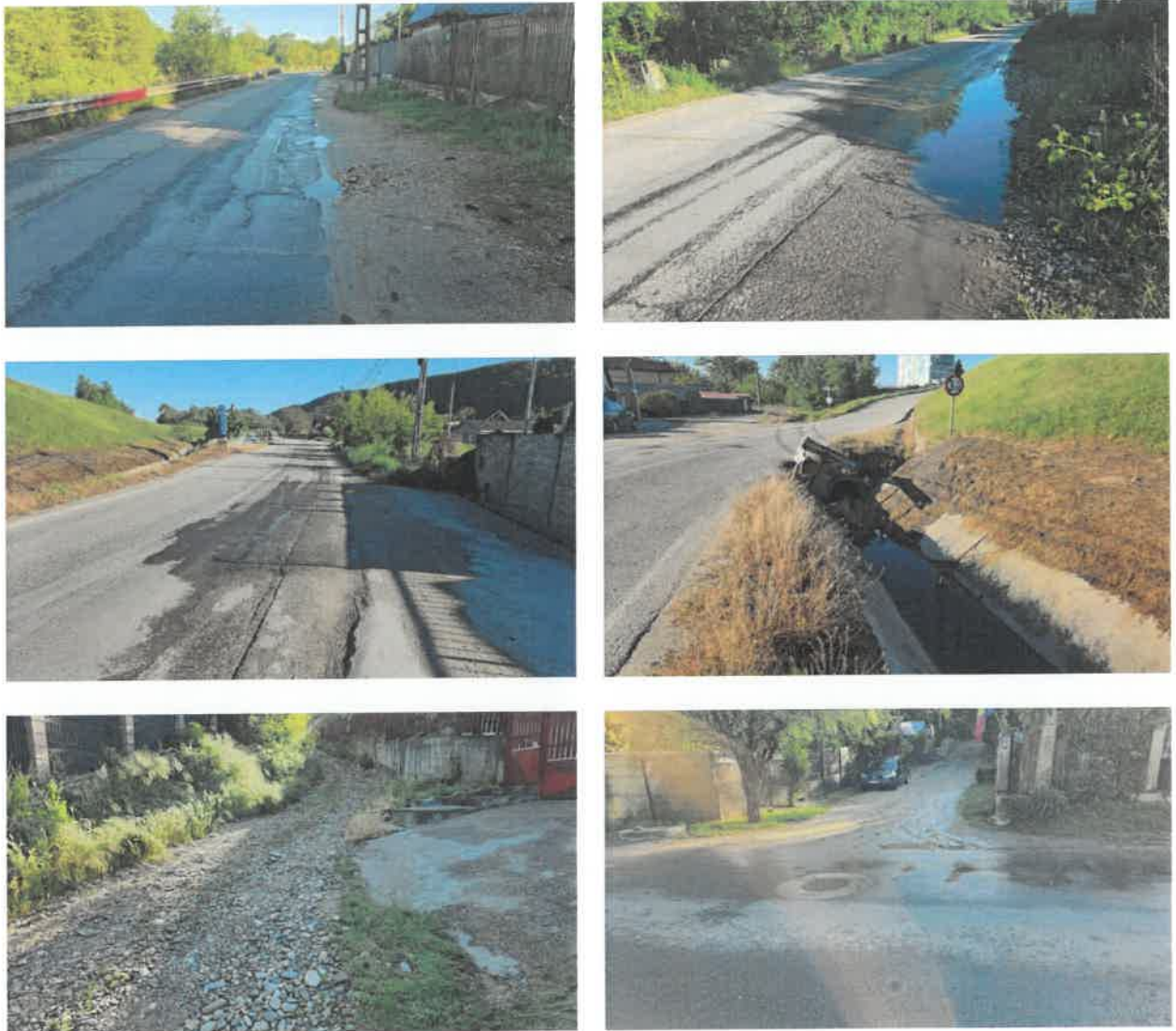
Figura 2. Aspecte foto relevante DC 291 + drumuri laterale
