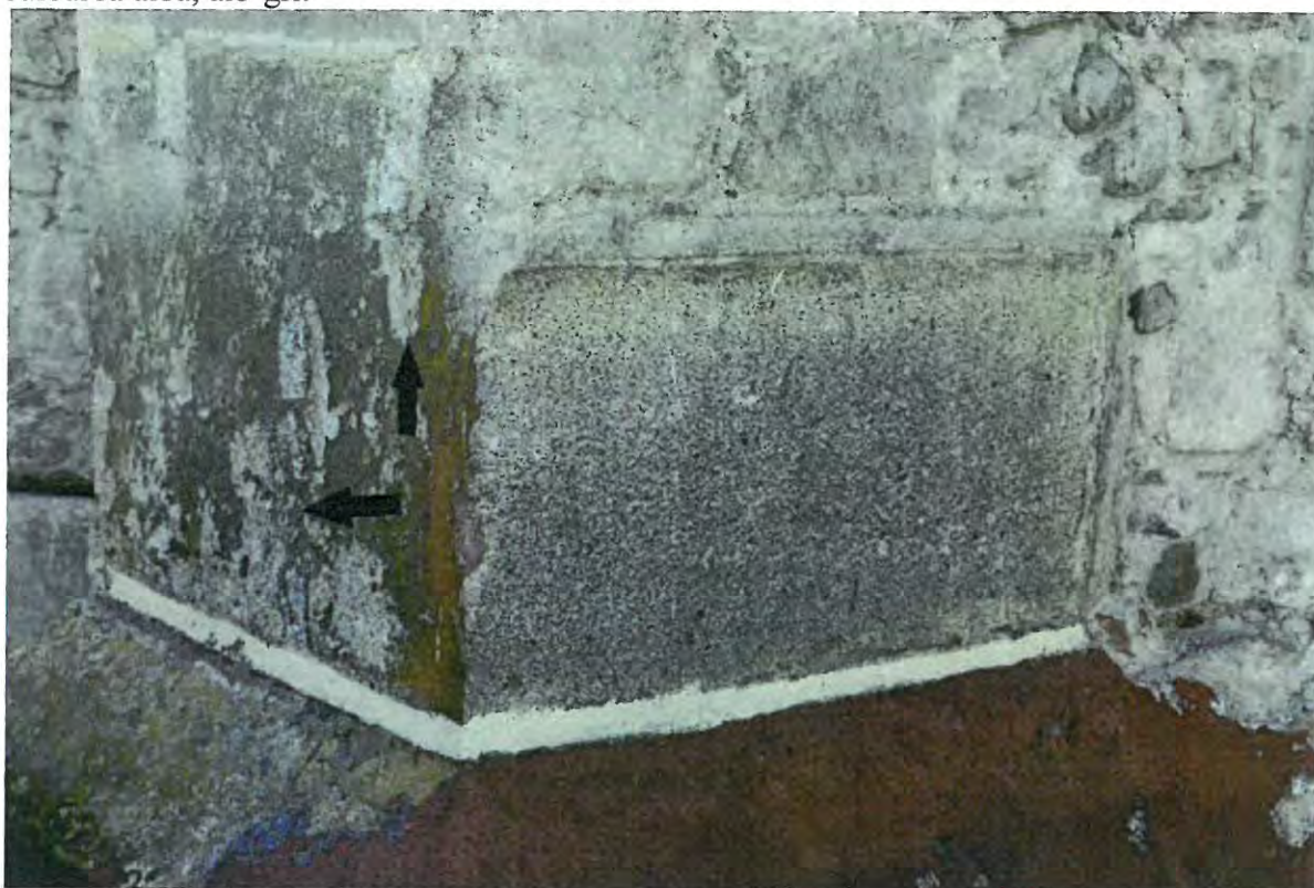
Fig.40. Prezența eflorescențelor saline, contrafort latura nordică.
