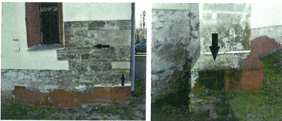
Fig.41. Prezența atacului biologic, fațada de nord
