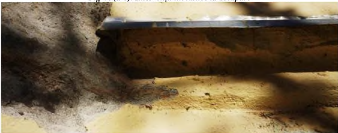
Fig. 45. Detaliu de reparație inadecvată la brâul median din piatră
