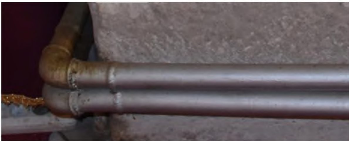
Fig. 47. Prezența unor cruste de substanță organică (ceară). Țevi neadecvat utilizate
