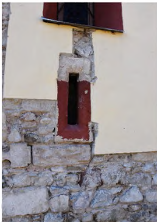
Fig. 11. Ancadrament nefuncțional est
