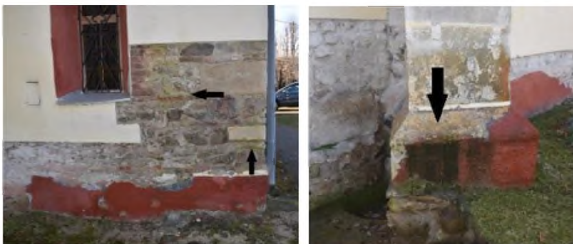
Fig.41. Prezența atacului biologic, fațada de nord
