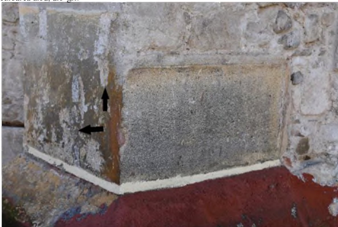
Fig.40. Prezența eflorescențelor saline, contrafort latura nordică.
