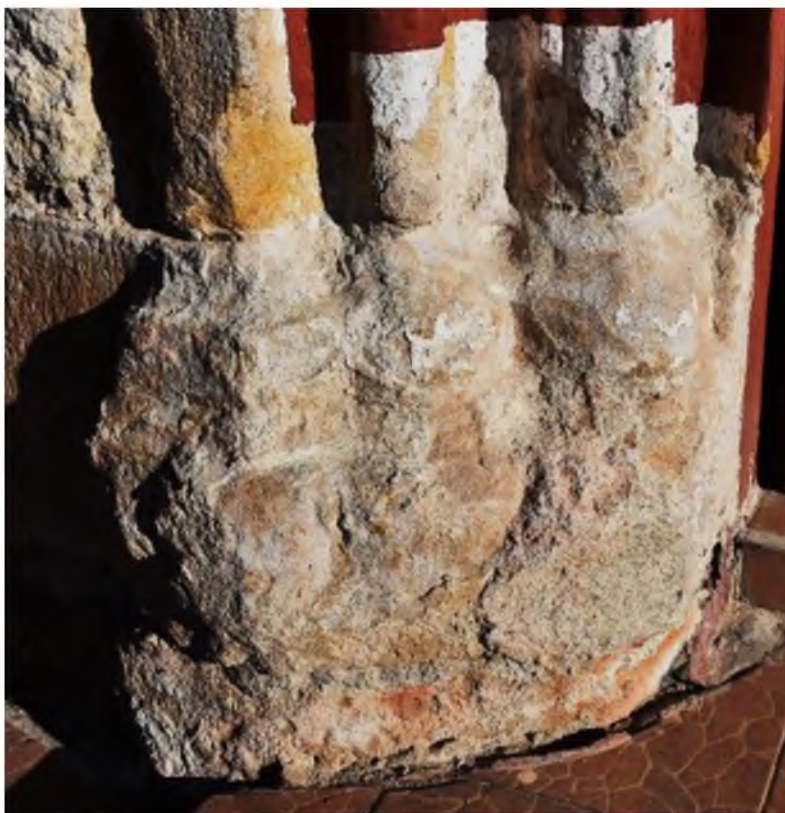
Fig. 38. Degradarea prin dizolvare a gresiei sub acțiunea acizilor din apa meteorică. Baze montanți portaluri
