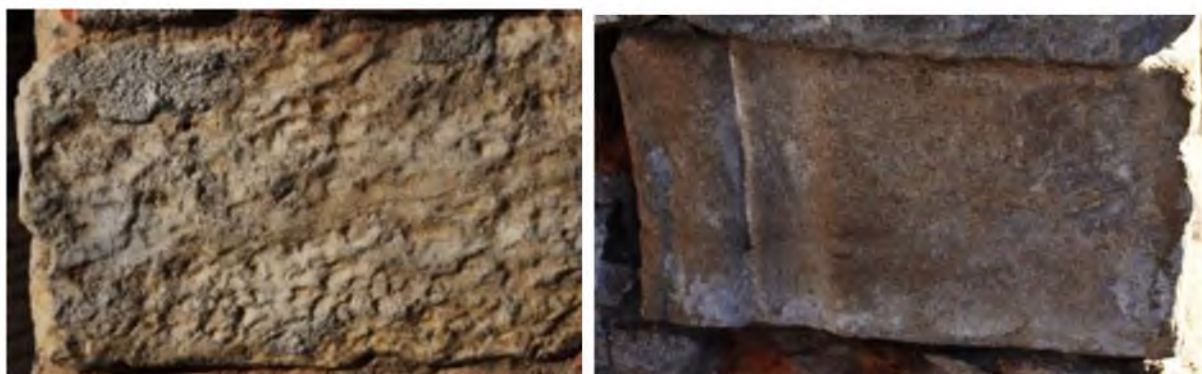
Fig. 37 (a-b). Fenomenul de dizolvare la rocile sedimentare sub acțiunea chimică a apei pluviale poluate. Piatră de colț, molon contrafort sud-vestic.
