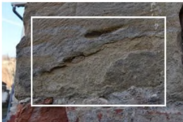
Fig. 36. Dezagregarea și exfolierea unui molon de gresie sub acțiunea ciclurilor repetate de îngheț-dezghet
