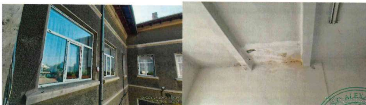
Figura 4 – infiltrații la nivelul planseului sub pod, peste etajul 1
