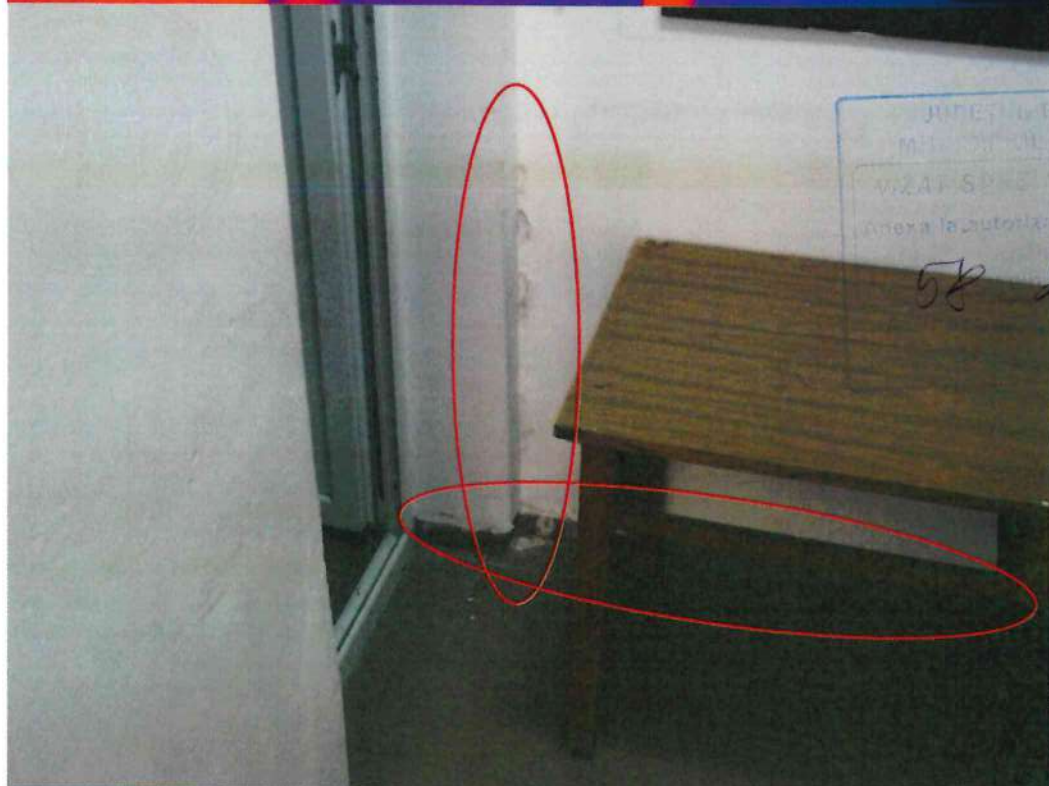
Figura 18 – zone cu umiditate ridicată la nivelul subsolului clădirii
